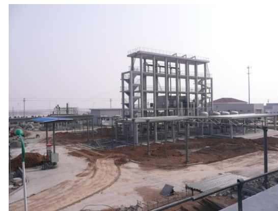
废油处理系统
